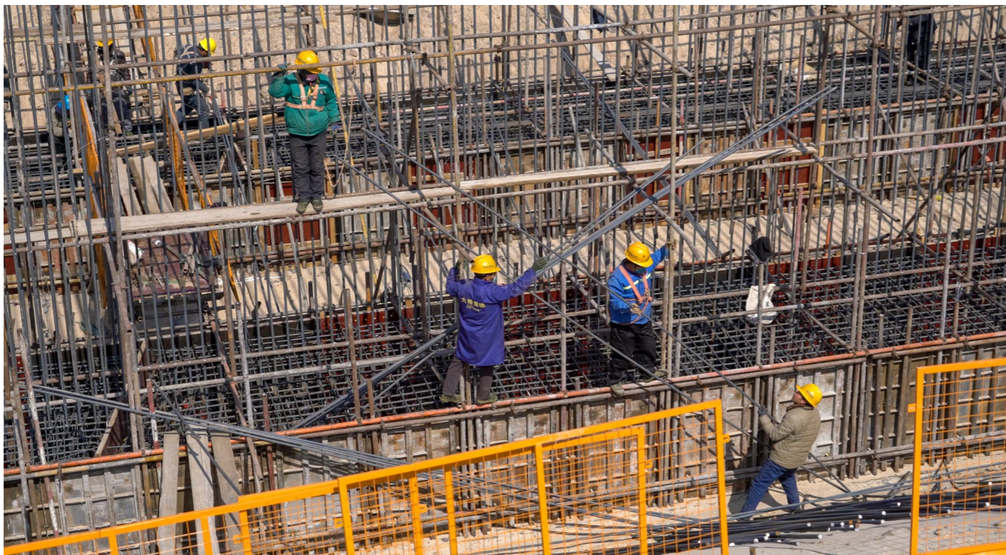
投资60.6亿元的丹锡高速经棚至乌兰布统段的西拉沐沦特大桥,高198米,创同类桥型国内之最。图为施工现场摄影原野
